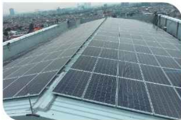
Pembangkit Listrik Tenaga Surya di atas Gedung Merah Putih BPOM, dengan kapasitas sebesar 75 Kilo Watt Peak (KWP)
